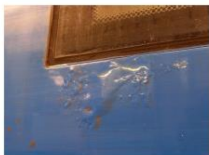
Foto 1. Corrosie linksonder deurblad.
